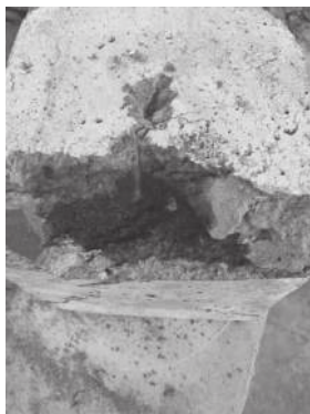
图 2 混凝土碳化状况
